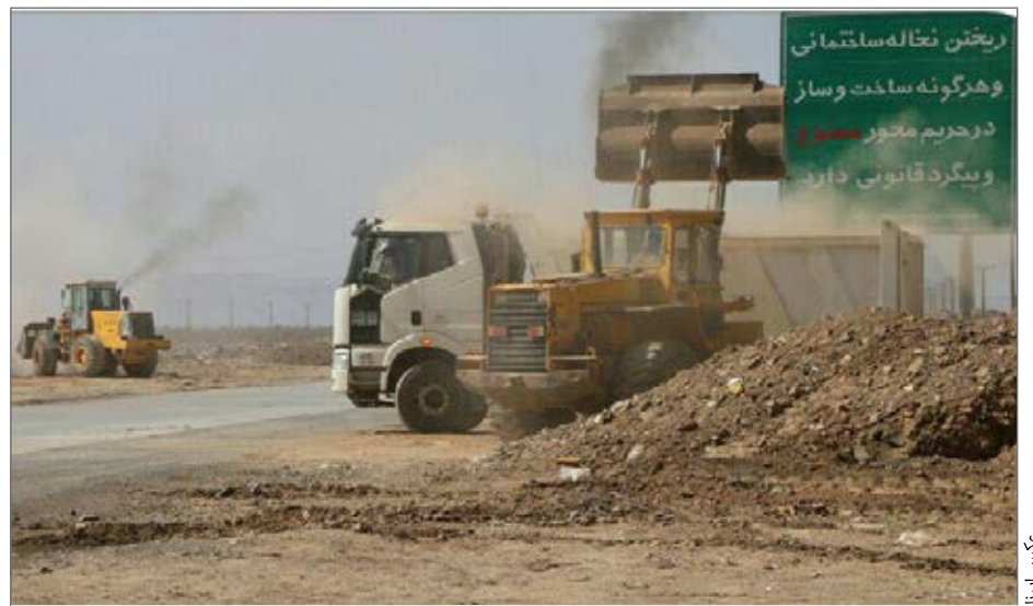
رها سازی نخاله های ساختمانی باعث به وجود آمدن چهره ای زشت از شهر شده اند.
