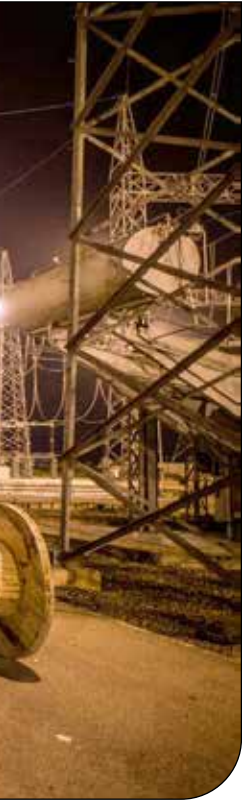
ایستگاه نیروگاه برق حرارتی
