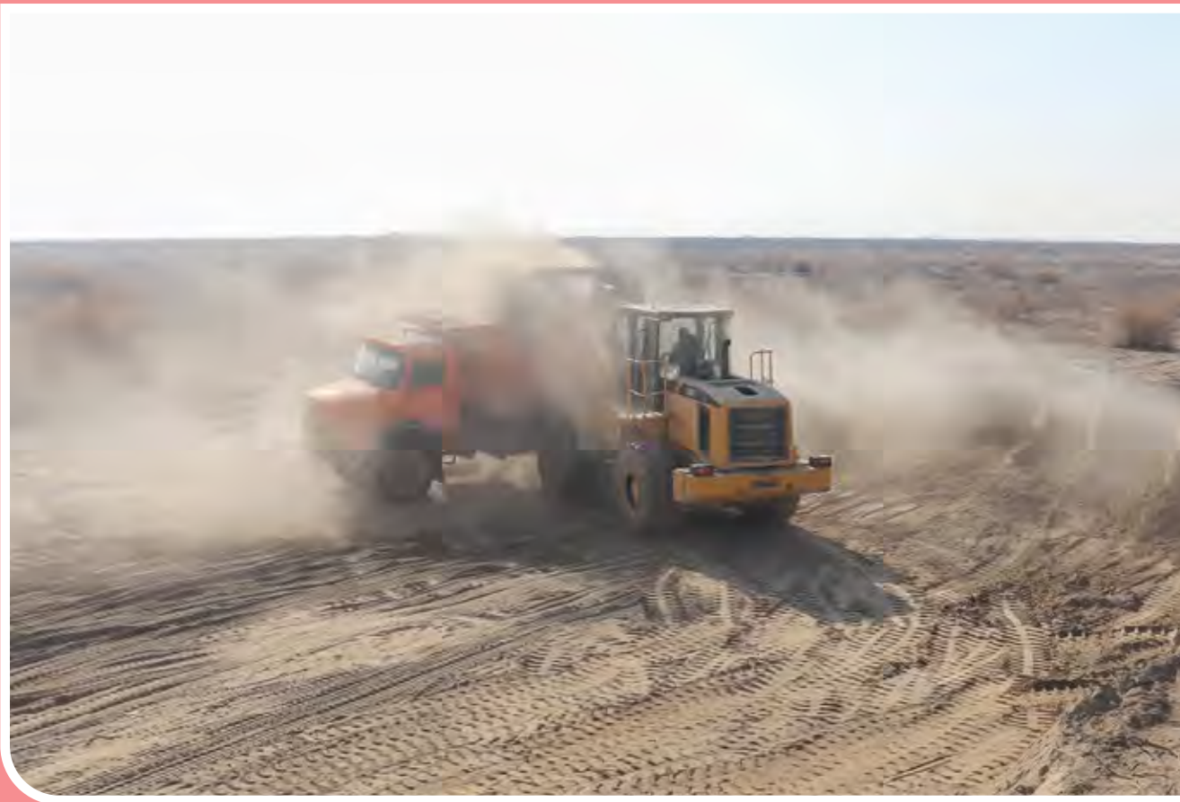
فصل جدید برداشت دندرسر ساز شن و ماسه از رودخانه «و فرقان» / برداشت غیرمجاز شن و ماسه از رودخانه «و فرقان» در امتداد رودخانه «قره‌چای» علاوه بر تخریب اکوسیستم منطقه، به جهت ایجاد گرد و غبار فراوان، به تهدیدی برای سلامت روستائینان روستاهای اطراف تبدیل شده و کیفیت محصولات کشاورزی باغی و زراعی آنان را نیز تحت تاثیر قرار داده است. / عکس از علی فرقانی
