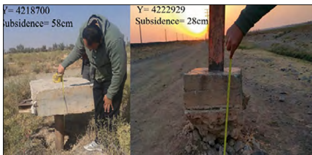
دو عکس آخر فرونشست زمین در دشت شبستر برگرفته از مقاله: «Introducing a new framework for mapping subsidence vulnerability indices (SVIs): ALPRIFT» نویسنده: عطاالله ندیری
