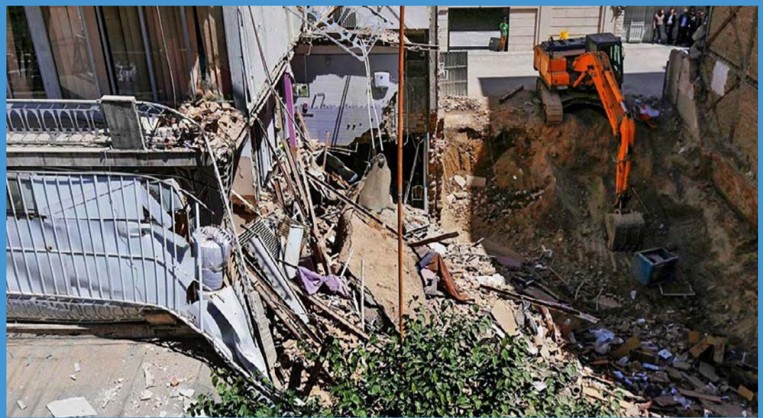
ریزش ساختمان چهار طبقه در تهران / مهر
